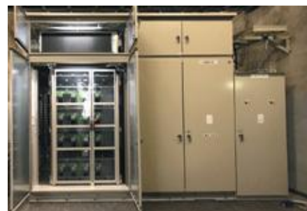
▲電力貯蔵装置(大型バッテリー)
