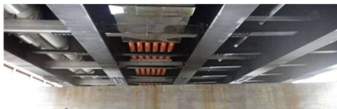
▲電力管路(橋の下から撮影)
