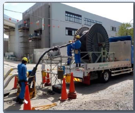
▲電力ケーブルの布設状況
