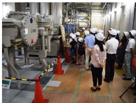
▲変電所内の見学
