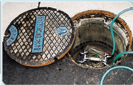
▲ 地 下 式 給 水 栓
