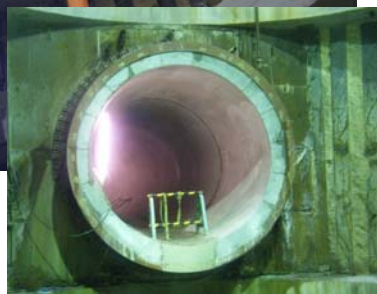
▲【雨水貯留管 入口】
