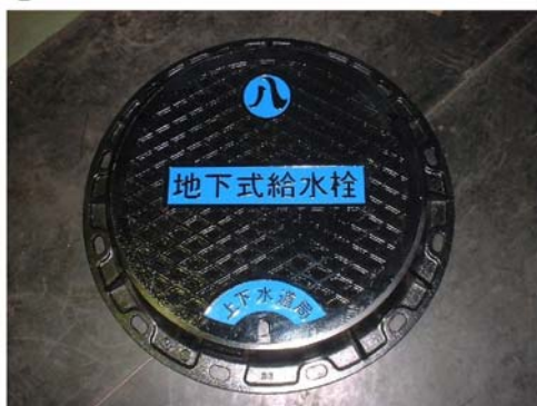
▲写真④「地下式応急給水栓」
